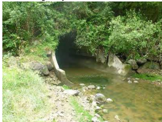
Busage du Sal sous la D 765, côté nord
